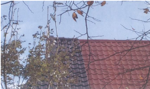
Slechte detaillering aansluiting dakpannen/dakpanprofielplaat
